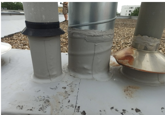
foto/22/ Pohled na vystupující instalační šachtu nad rovinu střechy s nesystémově opracovanými kruhovými prostupy
