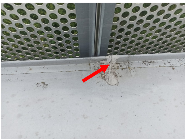
foto/34/ Pohled na okraj střechy nad pavlačí, trhliny ve spoji jednotlivých poplastovaných závětrných lištách
