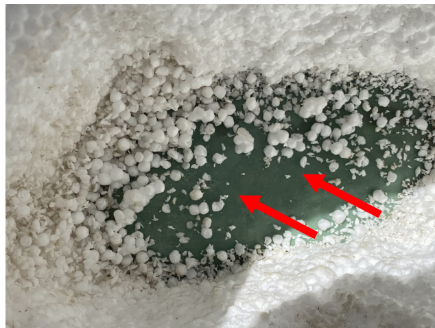
foto/13/ Pohled na viditelnou vlhkost pod PE fólií v místě sondy S2
