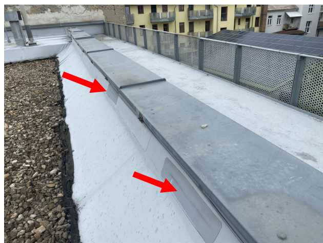
foto/35/ Pohled na velké množství záplat v místě stěny atiky
