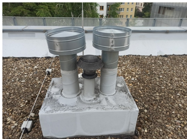
foto/21/ Pohled na vystupující instalační šachtu nad rovinu střechy s nesystémově opracovanými kruhovými prostupy
