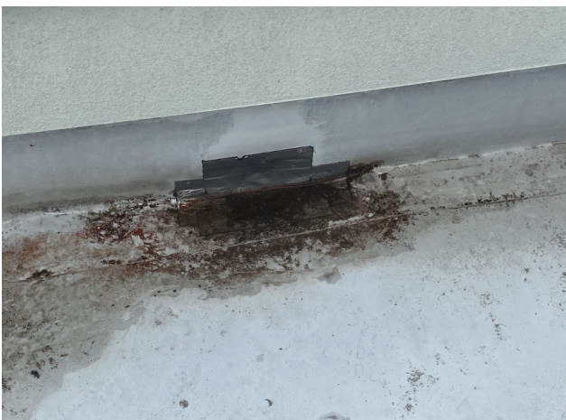
foto/40/ Pohled na zaslepený střešní vtok v místě střechy pavlače na severovýchodní straně objektu a stojící vodu
