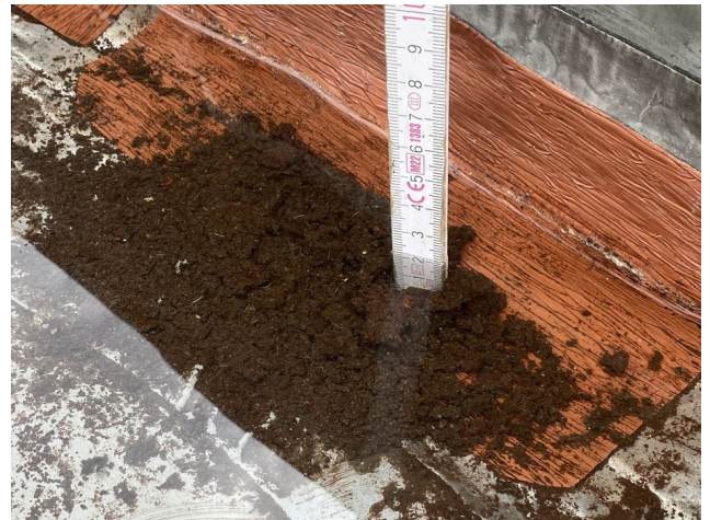
foto/39/ Pohled na zaslepený střešní vtok v místě střechy pavlače na severozápadní straně objektu a stojící vodu (výška hladiny vody cca 21 mm)
