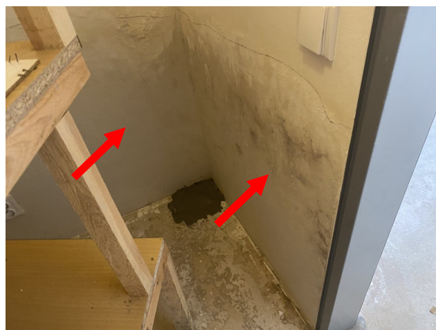
foto/45/ Pohled na vlhkostní mapy a degradaci omítek stěny v blízkosti instalační šachty v 1.NP
