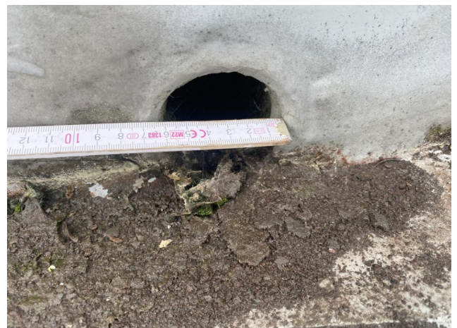
foto/41/ Pohled na průměr a nečistoty v blízkosti střešního vtoku na severovýchodní straně objektu (průměr cca 60 mm)
