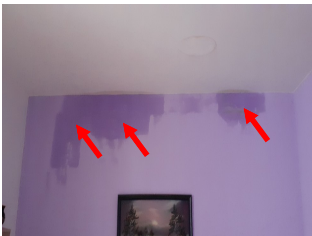
foto/1/ Pohled na vlhkostní poruchy v místě bytu na obvodové stěně na severozápadní straně objektu
