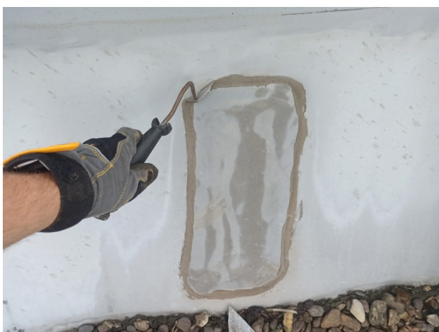
foto/28/ Pohled na netěsnost v místě zapravení netěsnosti pomocí záplaty z hydroizolační fólie spojenou střešním tmelem
