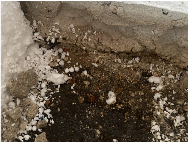
foto/58/ Pohled na vlhkost v místě sondy P2
