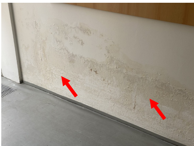
foto/3/ Pohled na vlhkostní poruchy v místě vedlejší místnosti v 1.NP
