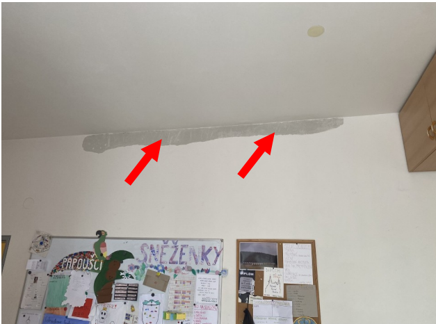
foto/46/ Pohled na opadanou omítku na stěně za instalační šachtou v 1.NP
