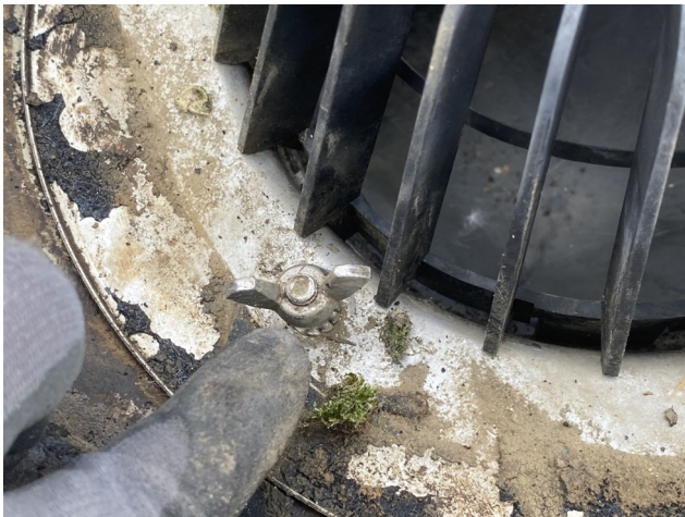
foto/38/ Pohled na povolenou křídlovou matici střešního vtoku
