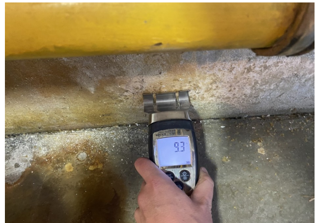
foto/49/ Pohled na naměřenou hmotnostní vlhkost stěny v místnosti kotelny (naměřeno 9,3%)
