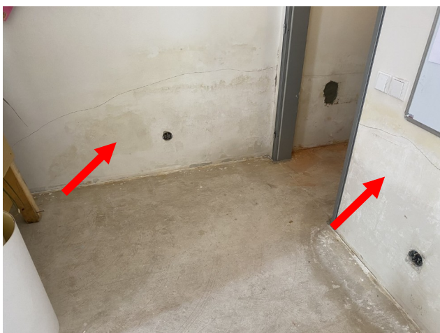
foto/44/ Pohled na vlhkostní mapy a degradaci omítek stěny v blízkosti instalační šachty v 1.NP
