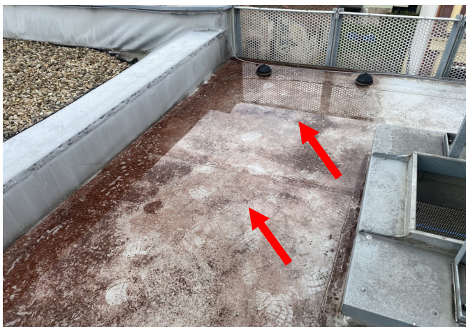
foto/18/ Pohled na kaluže v ploše střechy
