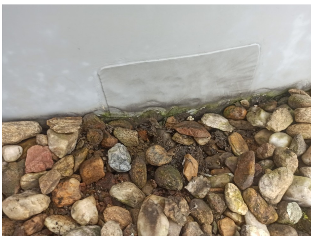
foto/30/ Pohled na záplatu z hydroizolační fólie
