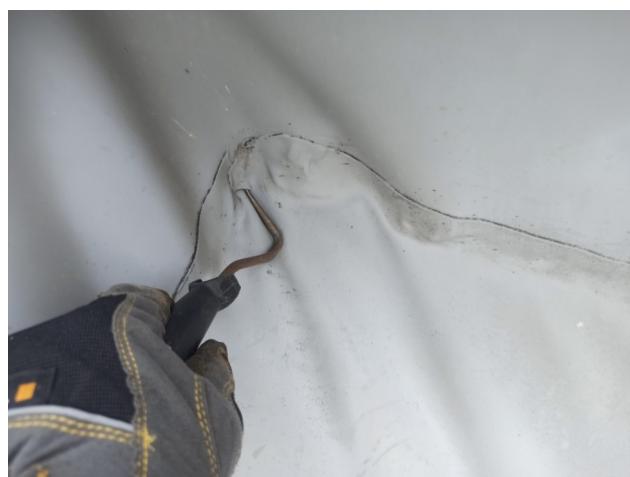
foto/29/ Pohled na netěsnost v místě záplaty z hydroizolační fólie
