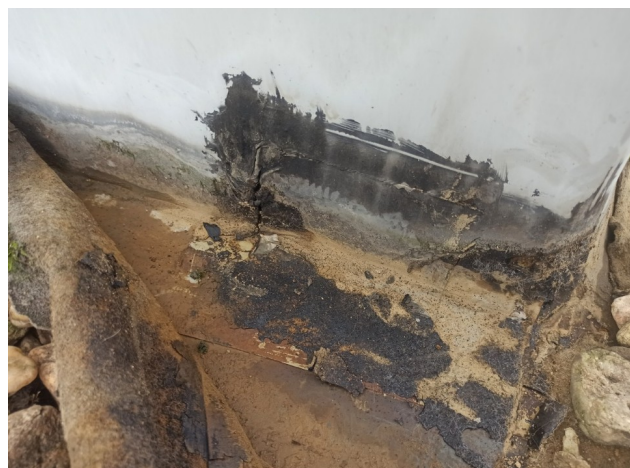
foto/23/ Pohled na zdegradované opracování instalační šachty
