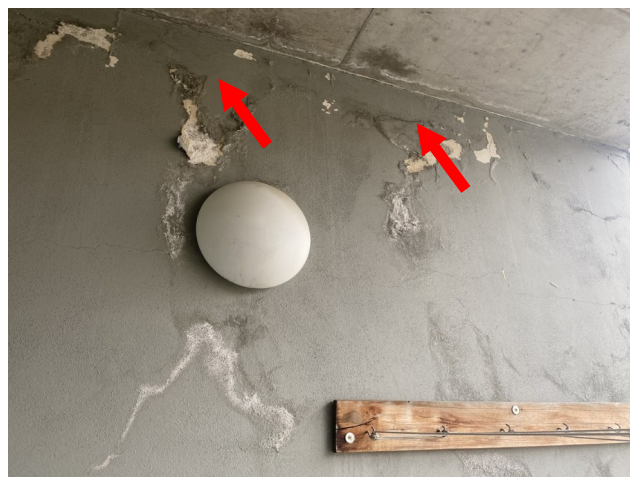
foto/2/ Pohled na vlhkostní poruchy z exteriéru na obvodové stěně na severozápadní straně objektu
