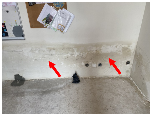
foto/4/ Pohled na vlhkostní poruchy v místě místnosti skautské klubovny v 1.NP
