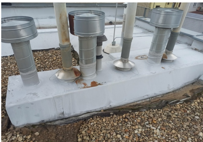
foto/20/ Pohled na vystupující instalační šachtu nad rovinu střechy s nesystémově opracovanými kruhovými prostupy
