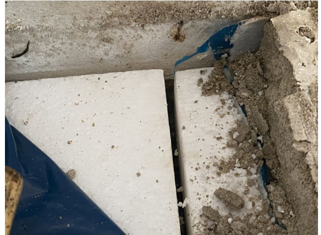
foto/57/ Pohled na viditelné mezery mezi tepelněizolačními deskami v místě sondy P2
