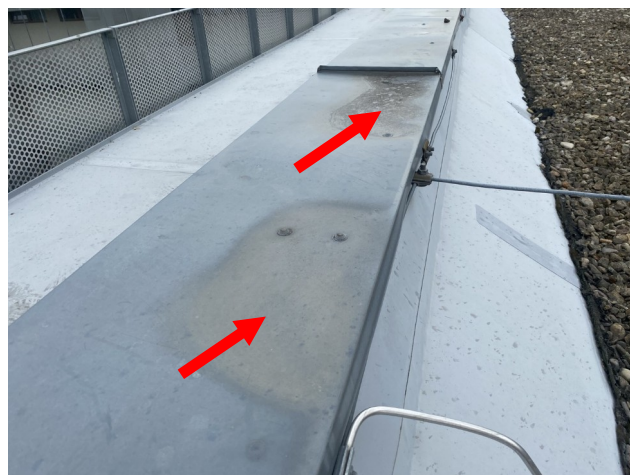
foto/27/ Pohled na zdeformované oplechování atiky a tvořící se kaluže
