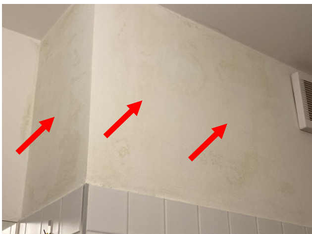
foto/42/ Pohled na vlhkostní mapy na stěnách instalační šachty ve 3.NP
