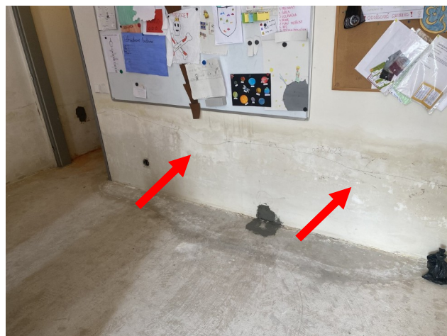
foto/43/ Pohled na vlhkostní mapy a degradaci omítek stěny v blízkosti instalační šachty v 1.NP
