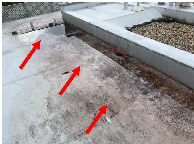
foto/19/ Pohled na kaluže v ploše střechy
