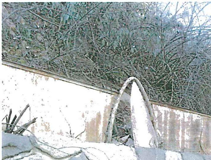
Obr. 7. Nefunkční plechové opěry jsou na některých místech přesypány sutí nebo proraženy kameny (foto O. Krejčí 3. 3. 2021).
