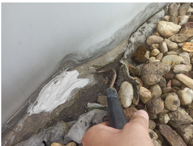
foto/30/ Pohled na netěsnost v místě záplaty v patě atiky
