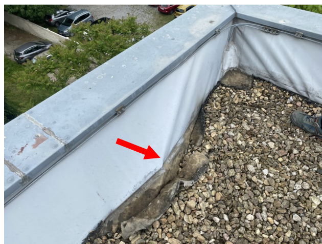
foto/33/ Pohled na odtržené kotevní prvky včetně koutových lišt v místě rohu atiky
