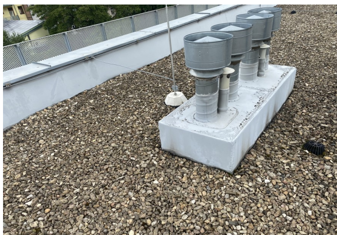
foto/16/ Pohled na vystupující instalační šachtu nad rovinu střechy s nesystémově opracovanými kruhovými prostupy
