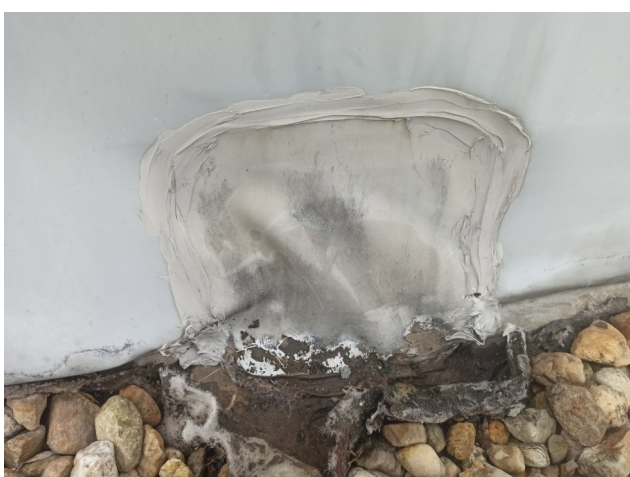
foto/28/ Pohled na záplatu v místě paty atiky
