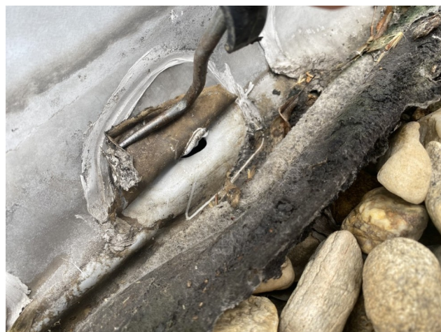
foto/25/ Pohled na netěsnost v místě záplaty v patě atiky
