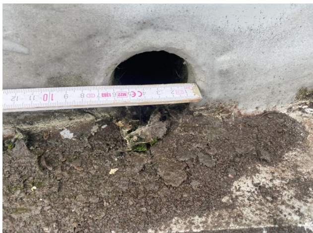
foto/36/ Pohled na průměr a nečistoty v blízkosti střešního vtoku na severozápadní straně objektu (průměr cca 60 mm)
