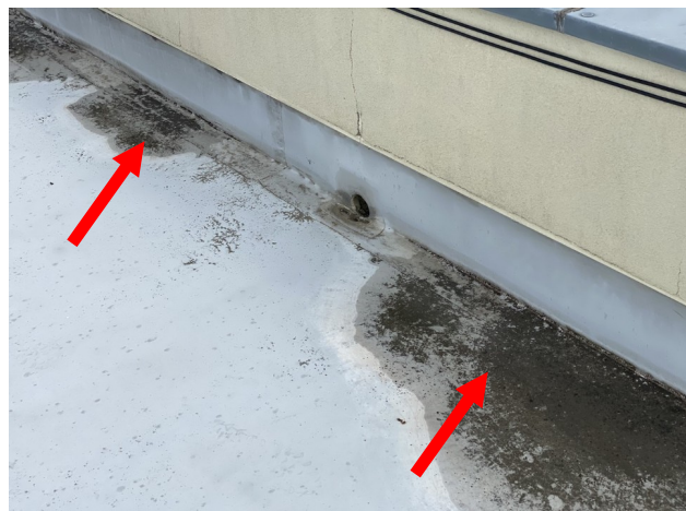
foto/11/ Pohled na kaluže v blízkosti atiky v místě střechy pavlače
