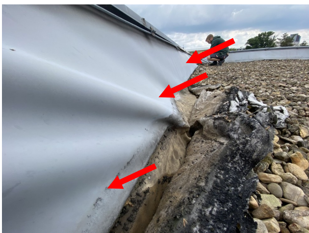
foto/32/ Pohled na odtržené kotevní prvky včetně koutových lišt v celé délce atiky
