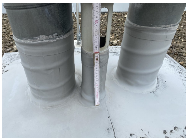
foto/17/ Pohled na zdegradované opracování instalační šachty
