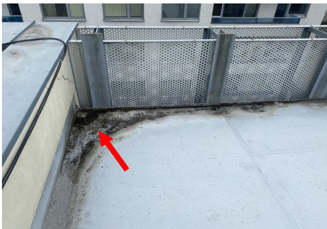
foto/10/ Pohled na nečistoty a kaluže v rohu střechy pavlače
