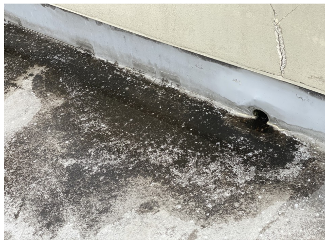
foto/37/ Pohled na nečistoty a stojící vodu v blízkosti střešního vtoku
