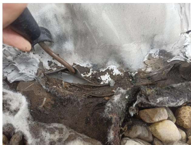
foto/29/ Detailnější pohled na netěsnost v záplatě v místě paty atiky
