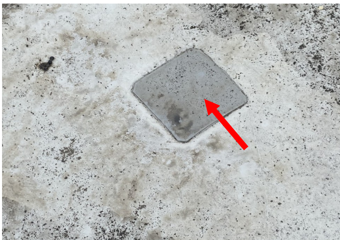
foto/12/ Pohled na záplatu v ploše střechy pavlače
