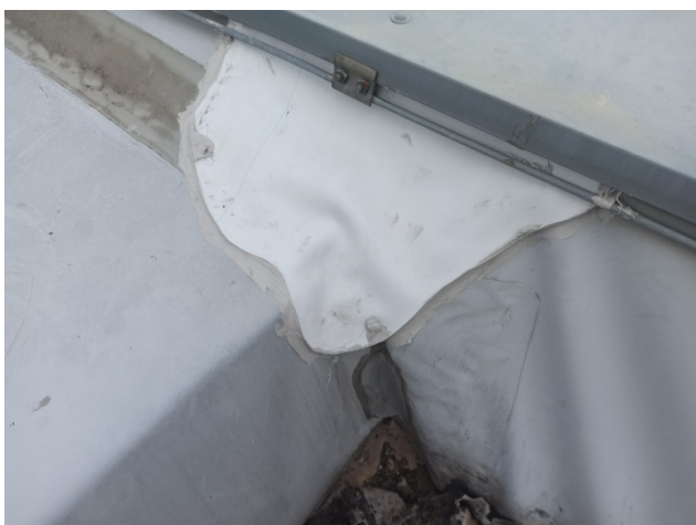
foto/26/ Pohled na záplatu v místě napojení atiky a dojezdu výtahové šachty
