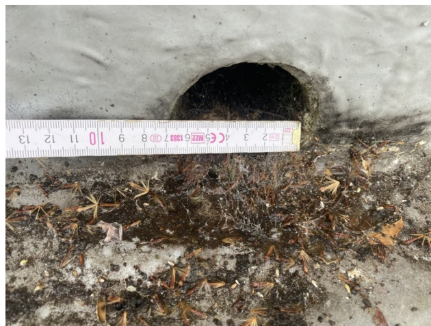
foto/32/ Pohled na průměr a nečistoty v blízkosti střešního vtoku na severozápadní straně objektu (průměr cca 60 mm)
