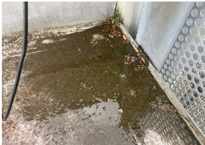
foto/12/ Pohled na nečistoty a kaluže v místě rohu střechy pavlače
