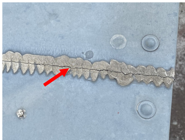
foto/22/ Pohled na spojení jednotlivých segmentů oplechování pomocí tmele, který je popraskaný
