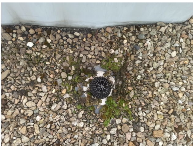
foto/29/ Pohled na střešní vtok opatřený ochranným košem v blízkosti instalační šachty a na nečistoty v podobě mechů a lišejníků
