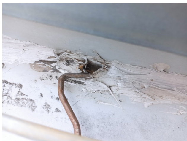
foto/24/ Pohled na netěsnost v místě oplechování atiky
