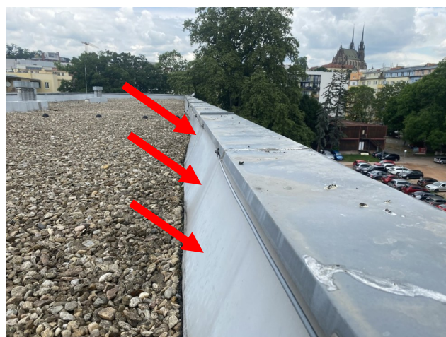
foto/28/ Pohled na odtržené kotevní prvky včetně koutových lišt v celé délce atiky
