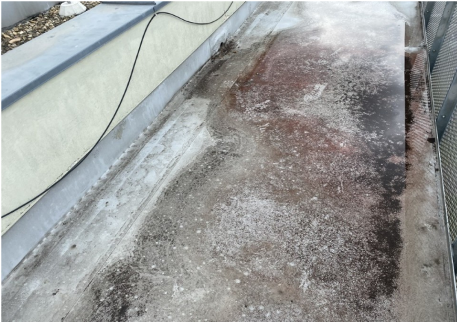
foto/10/ Pohled na nečistoty a kaluže v místě střechy pavlače
