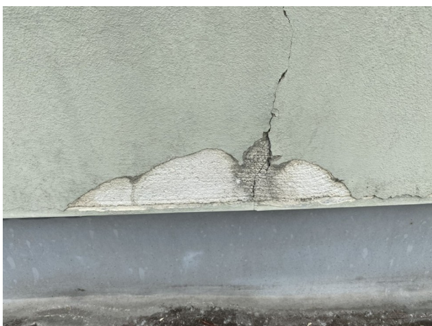
foto/25/ Pohled na zdegradovanou stěnu atiky v místě pavlače
