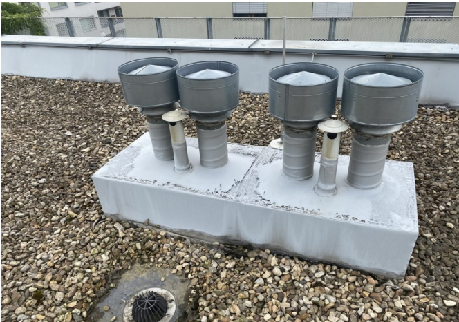
foto/15/ Pohled na vystupující instalační šachtu nad rovinu střechy s nesystémově opravenými kruhovými prostupy
