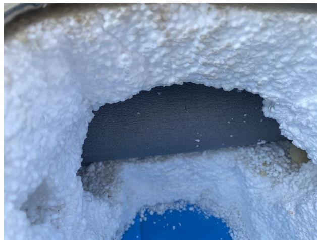
foto/6/ Pohled na vodorovné potrubí střešního vtoku pavlače v místě sondy S1
