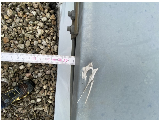
foto/21/ Pohled na vzdálenost hrany okapnice od vnějšího líce fasády (~30 mm)
