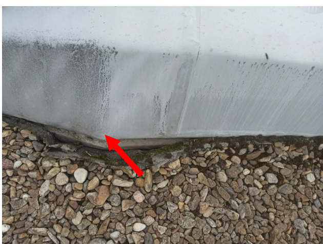
foto/27/ Pohled na odtržený kotevní prvek včetně koutové lišty v místě atiky
