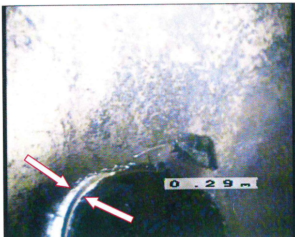
FOTO 001: 0,4m - odchylna polohy, podélná - axiální, cca 1 - 2cm, možná exfiltrace
