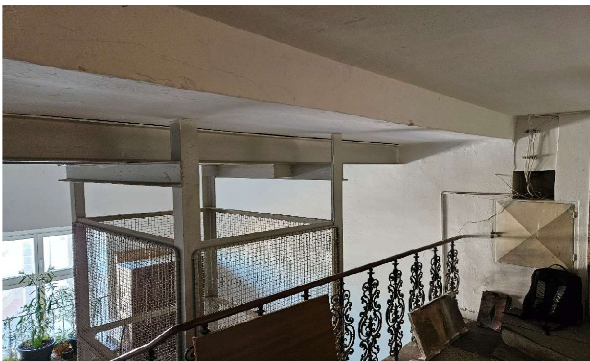
Různé výškové úrovně stropu v 5.NP a kotvení šachty výtahu do podélných zdí v chodbě
