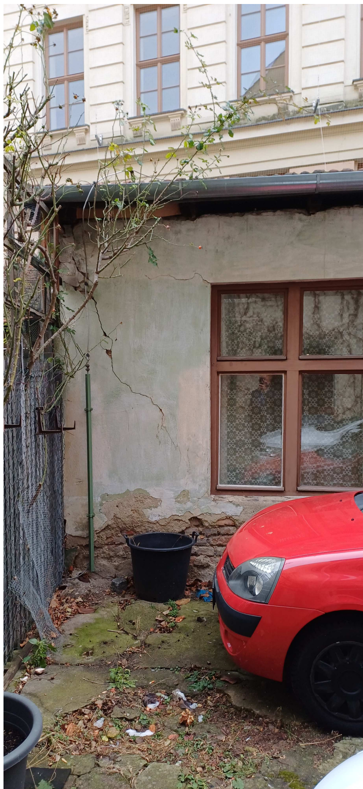
Trhlina od nerovnoměrného sedání nižšího objektu v exteriéru.
