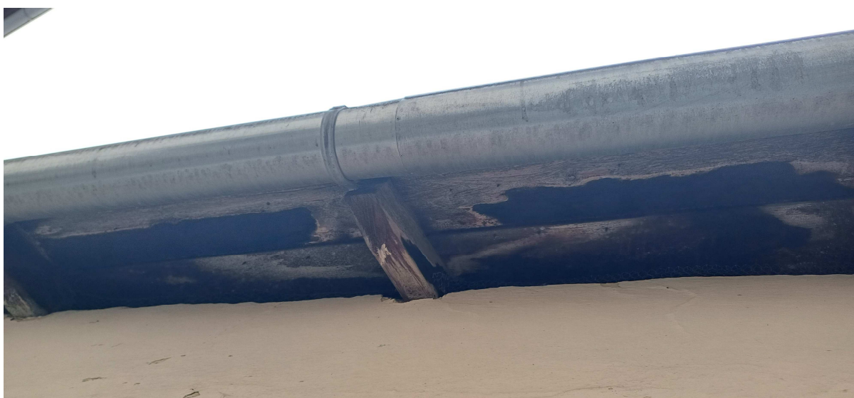
Plesnivé krokve a dřevěný záklop v exteriéru
