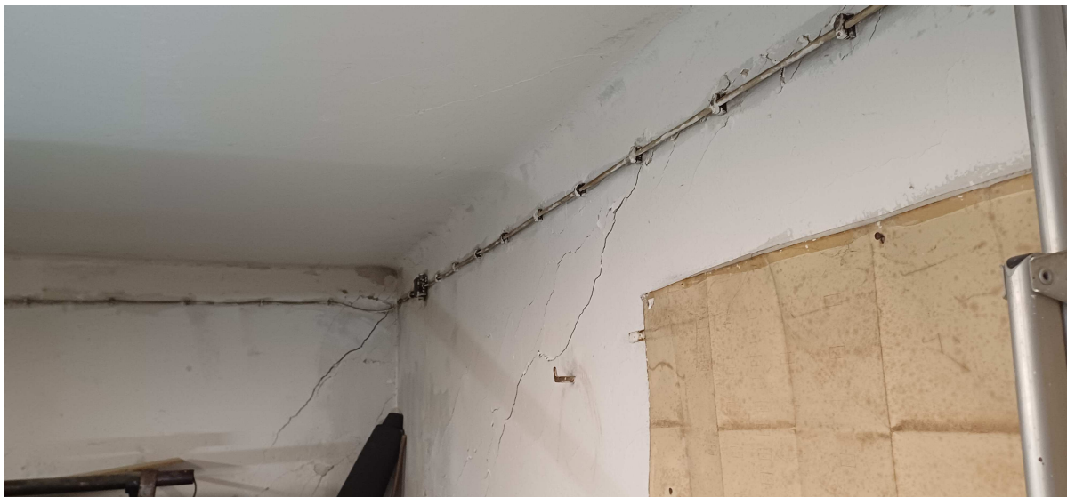
Trhliny v zadní pravé části kuželnárny – u mechanizace s kuželky
