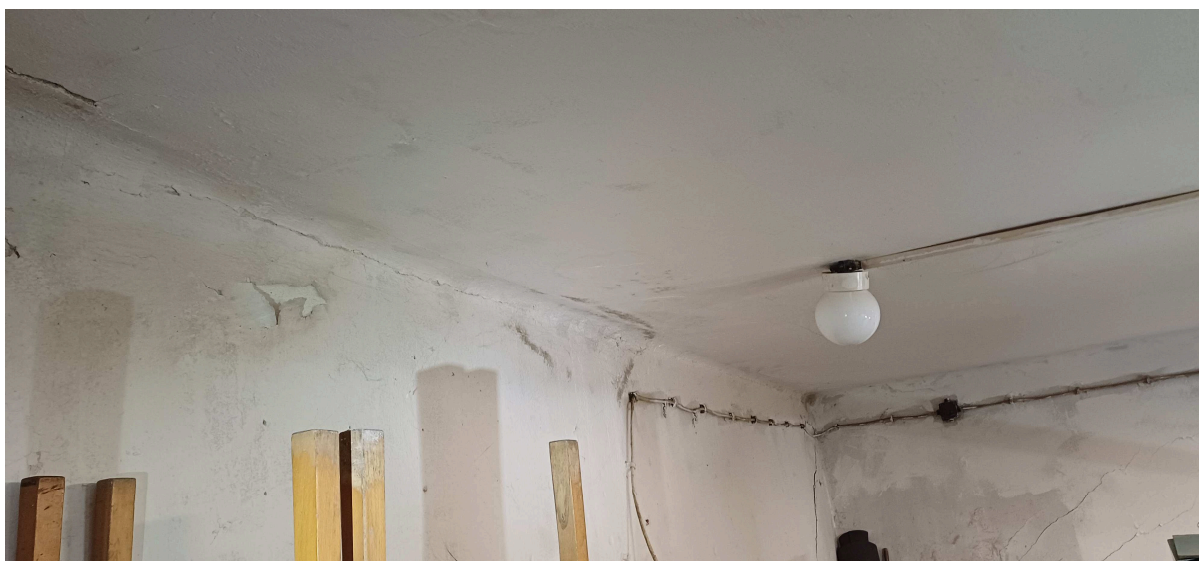
Plísně a vlhký strop
