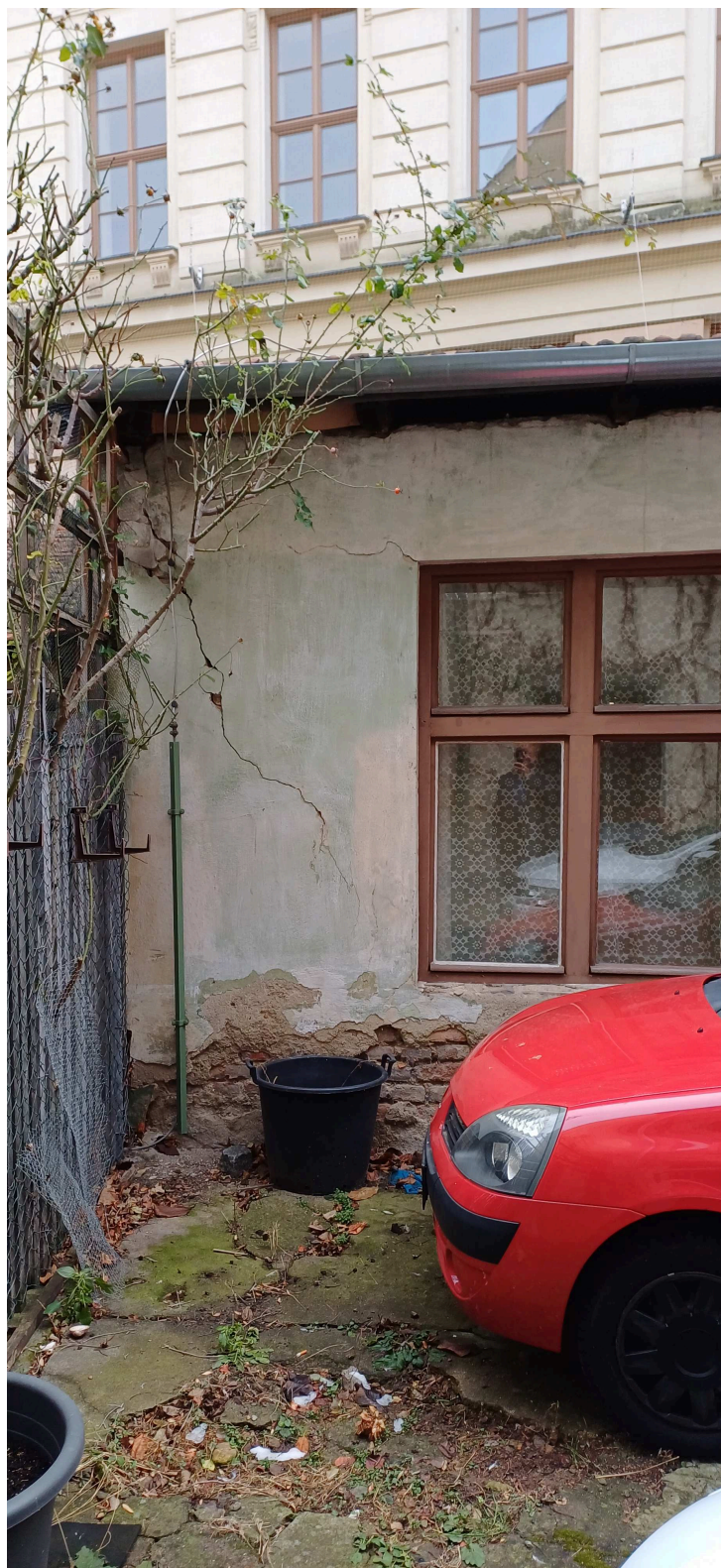
Trhlina od nerovnoměrného sedání nižšího objektu v exteriéru.
