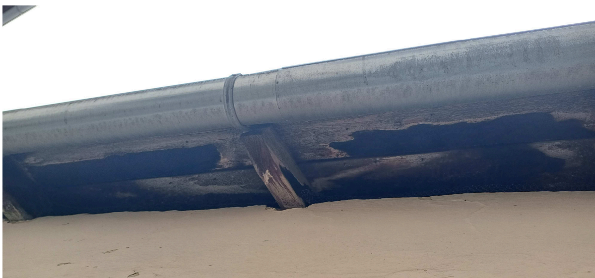
Plesnivé krokve a dřevěný záklop v exteriéru
