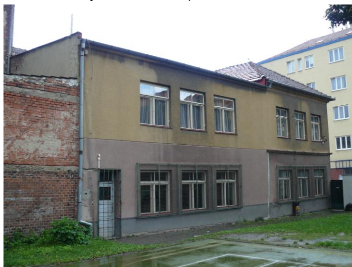
Obr.č.21 – celkový pohled na dvorní fasádu: poškozený sokl, špatně vyřešené napojení zpevněných ploch, stékání dešťové vody po fasádě díky neoplechovaným římsám a poškozeným okapům
